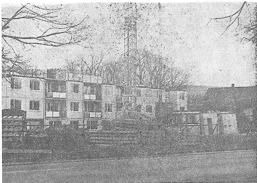
Snímek Drahoslava Dána je z ledna t. r., ale dnes stavba vypadá už jinak. Byla zahájena v červenci 1987 a s ukončením se počítá v červenci 1989.
