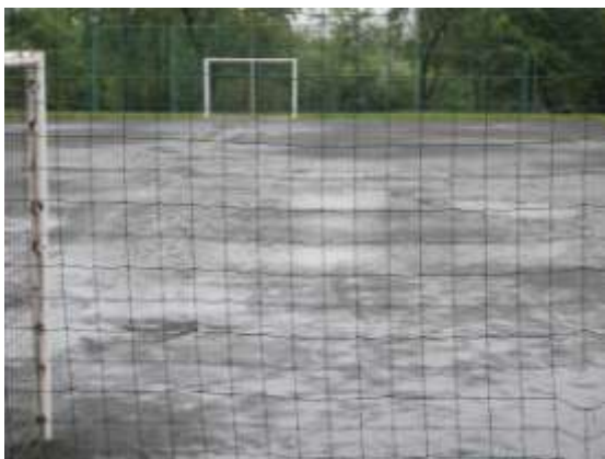
Obrázek 378 Po vydatných deštích bylo hřiště doslova pod vodou
