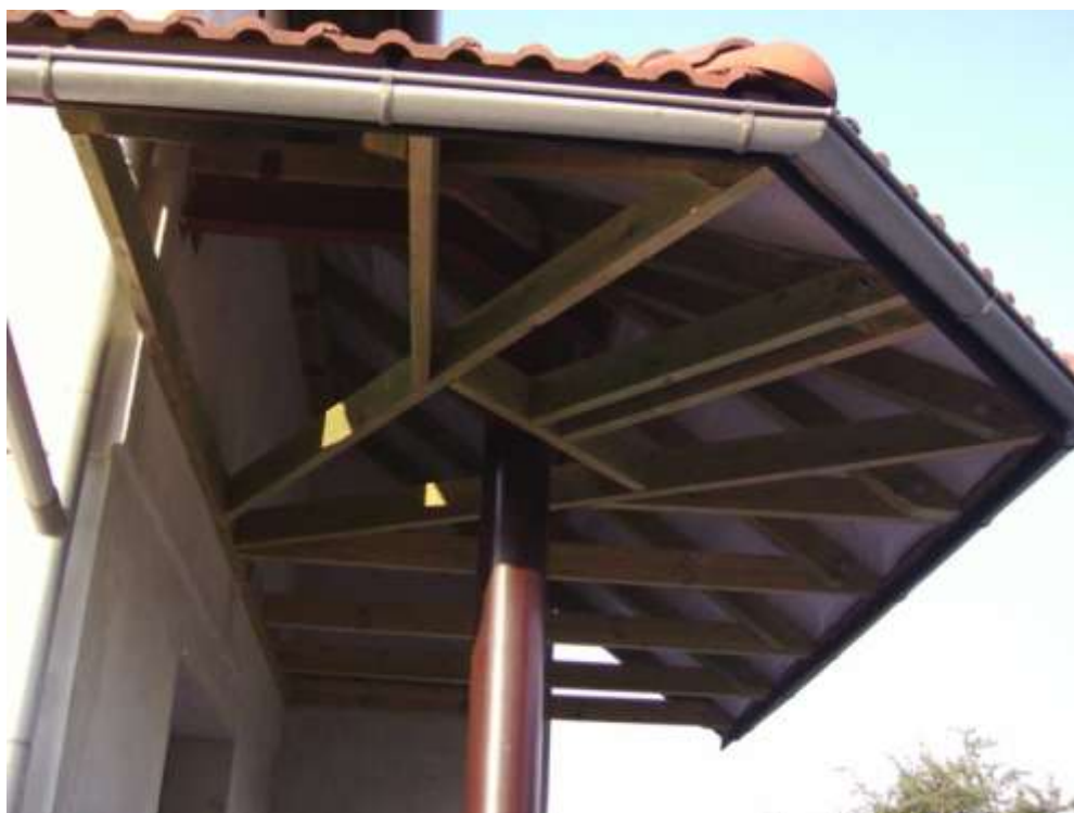
Obrázek 67 Chybí podbití, je vidět, že konstrukce je bytelná
