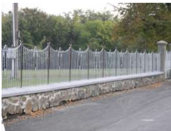
Obrázek 395 Plot je opraven
