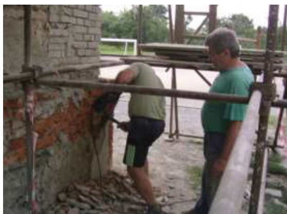
Obrázek 171 Zvětralou fasádu bylo nutné osekát
