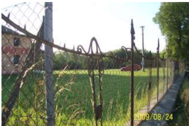
Obrázek 384 Původní plot před opravou
